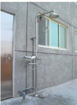
▲緊急沖身洗眼器設備。
