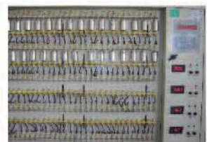
▲聖力源鎳氫電池檢測室。
